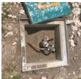
*Cableado de manera directa.
